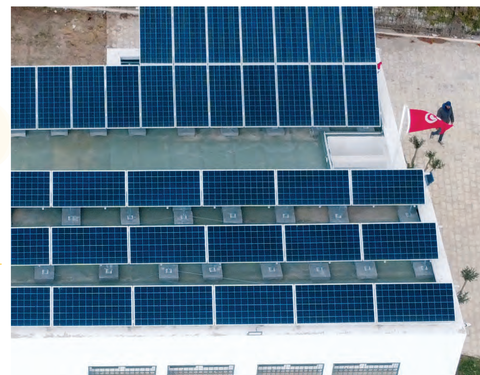
Toit solaire, bâtiment municipal - Hmadet Douik
